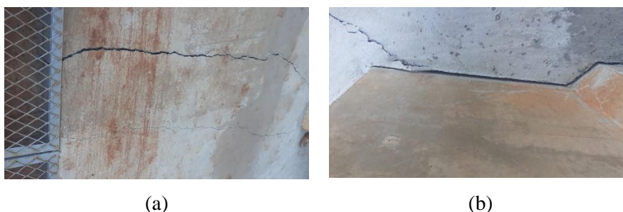
Figura 7. Trincas no piso no entorno da estrutura. (a) Piso trincado. (b) Fenda entre piso e pilar.
