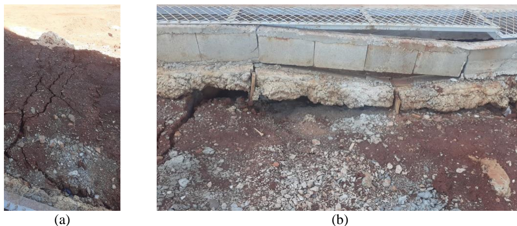
Figura 8. Movimentação do aterro. (a) Trincas no talude de aterro. (b) Rebaixamento do aterro.
