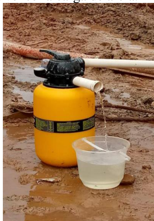
Figura 6 - Filtragem em filtro pressurizado de areia tratada
