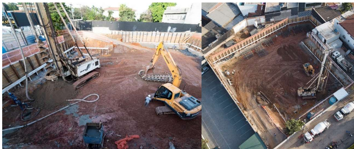
Figura 3. (a) Detalhe da execução da estaca hélice e (b) Vista aérea da obra
