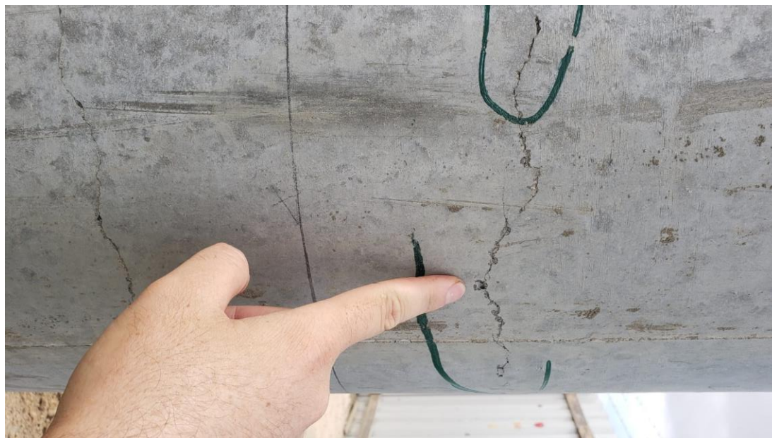
Figura 1: Estaca com abertura de fissura da ordem de 0,4 mm (esta estaca pode ser usada apenas para carga de compressão. Se for usada para carga de tração deve-se levar em conta a espessura de compensação da corrosão).
