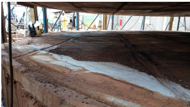
Figura 13. Calda de cimento presente sob o fundo do tanque
